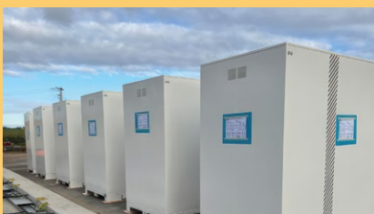
6 batteries = 1,3 MW de stockage
